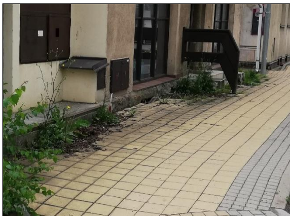
Zanedbaná údržba chodníku s prorůstající zelení (projekt č. 17)
